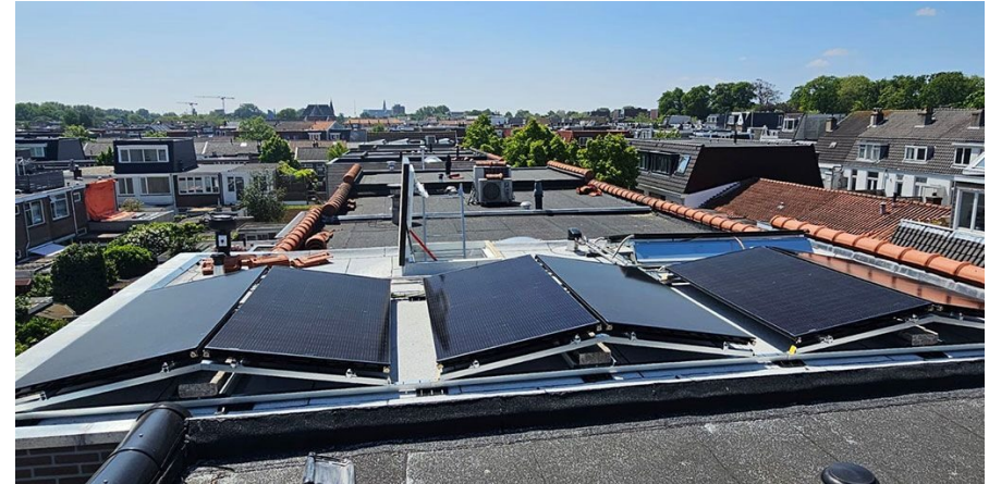
Figuur 12 – PVT-panels voor een PVT-warmtepomp.
